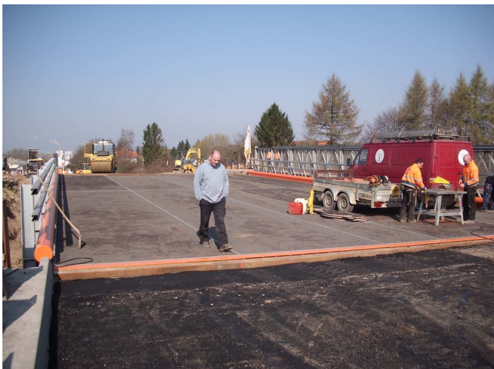
Fertiggestellte Behelfsbrücke mit Übergang für vier Fahrbahnen, schwere Geländer nach Anprallklasse A = 100 kN
